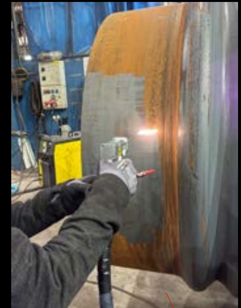
Afrensning af rust på fjernvarmerør
